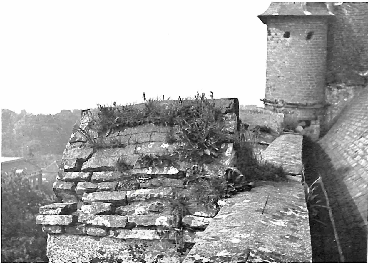
PLANTENGROEI TUSSCHEN DE AFDEKKING DER CONTRAFORTEN OP HET DAK VAN HET KOOR DER ZALTBOMMELSCHER KERK
