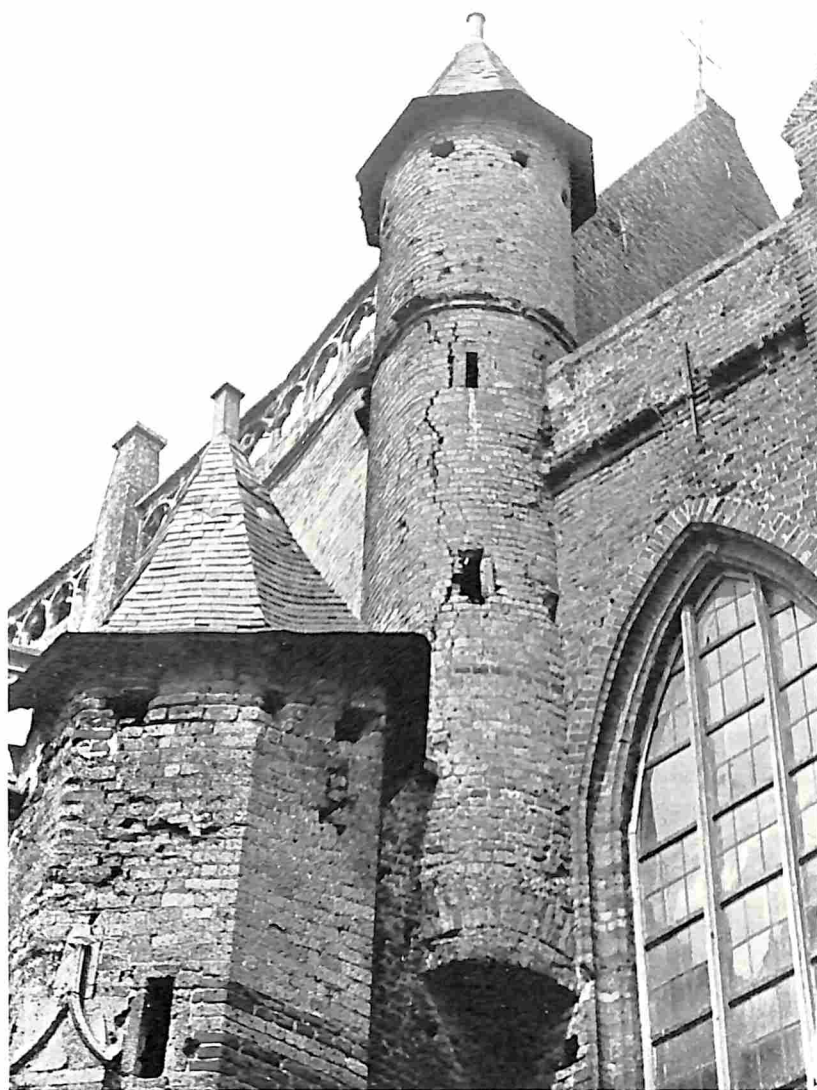
DE TOP VAN DEN GESLOTEN TOREN ENDE UILENTOREN AAN DE ZUIDZIJDE DER KERK TUSSEN KERK EN KOOR. MEN LETTE OP DEN VERVALLEN TOESTAND!
